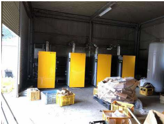
木質バイオマスボイラー
