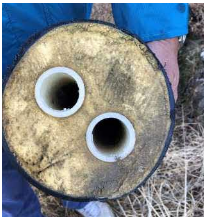
断熱材で覆われた配水管
