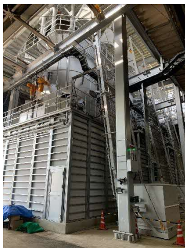
▲乾溜ガス化炉と投入バケツ
