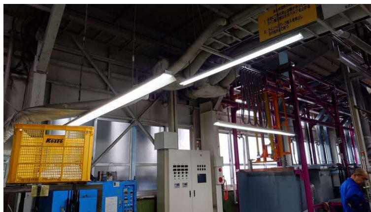
▲切り替えを進めた工場内の LED 照明
